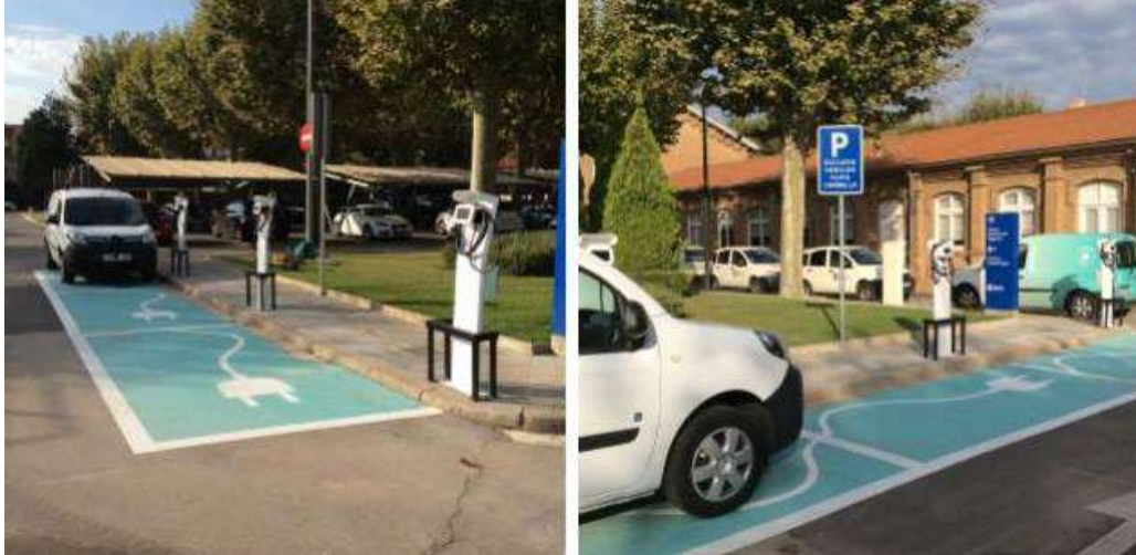
Detall carregadors amb totem de suportació per a exteriors a la Central Cornellà
