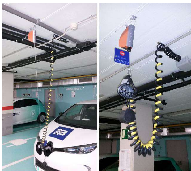
Detall del sistema de càrrega des de sostre amb les mesures de prevenció nomenades.
