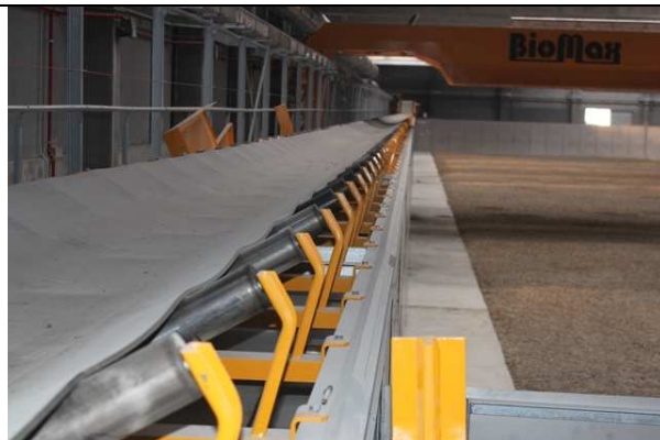
Cinta d'entrada de FORM al reactor
