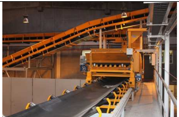
Tripper – dosificador de materials al reactor.
