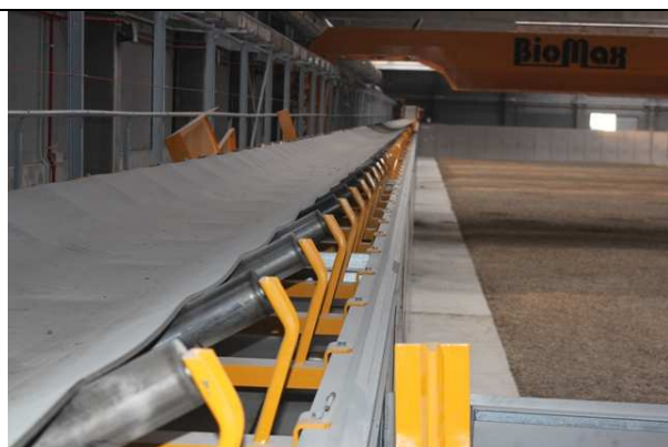
Cinta d'entrada de material al reactor
