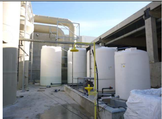
Dipòsits d'emmagatzematge d'àcids.
