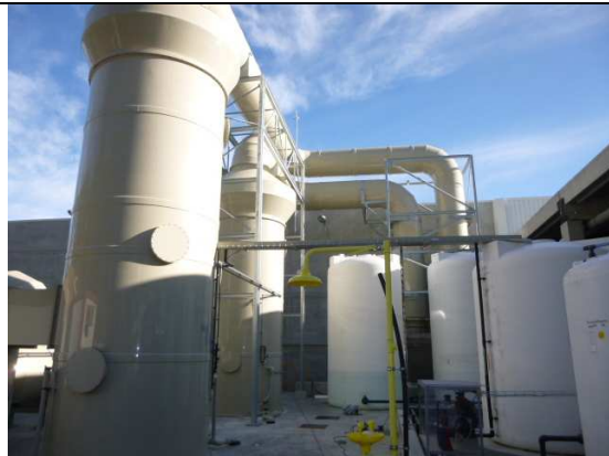
Scrubber en primer pla i humidificador al fons
