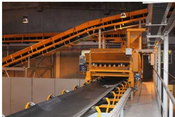
Tripper – dosificador de materials al reactor.
